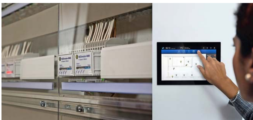
AMX-Controller steuert Aktorik und Sensorik von NOXnet, wie in einem aktuellen Objekt am Thunersee.
