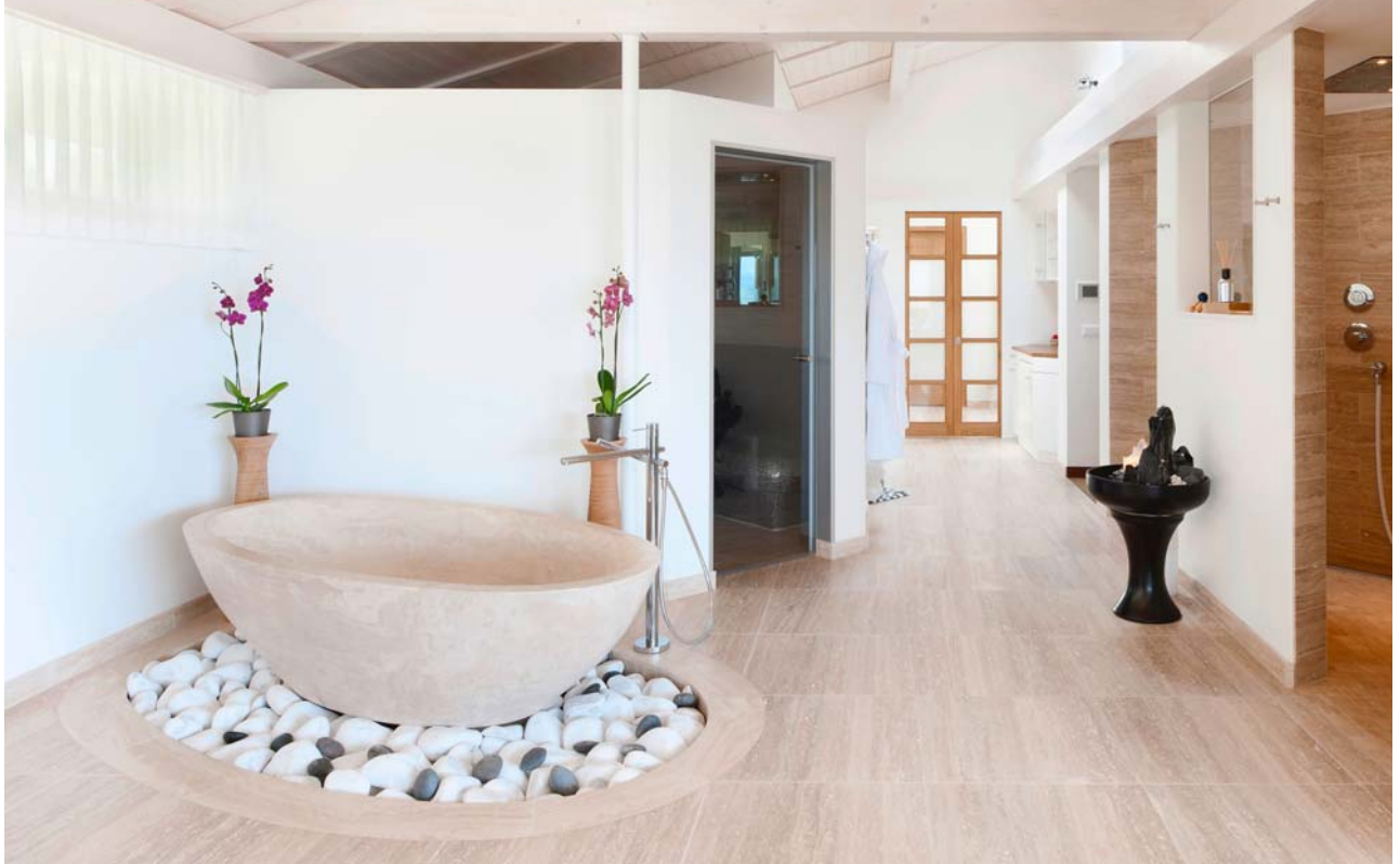
Ein Blick ins Wohnbad: im Hintergrund ein Touchpanel und ein Elektronikaster zur Bedienung des Gebäudeautomationssystems NOXnet von Innoxel.
