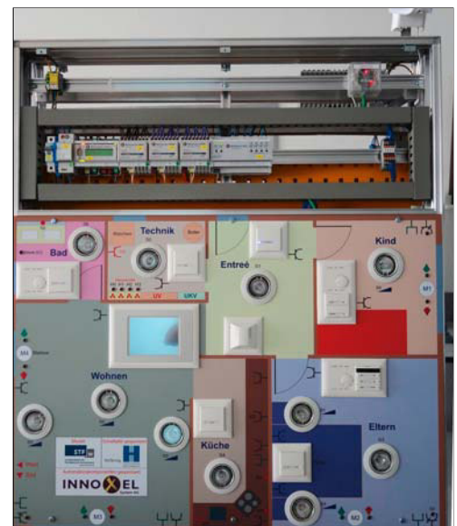
2) Modell NOXnet von Innoxel, im Wohnzimmer Panel für Bedienung aller Funktionen, oben sichtbar die notwendigen Reiheneinbaugeräte.
