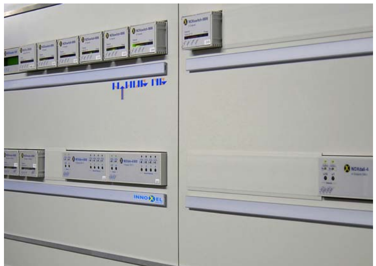
Im Verteiler ist genügend Platz frei, damit auch der Rest des Hauses noch automatisiert werden kann.
