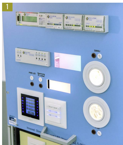
Lichtmodell integriert alle modernen Ansteuertechniken von LED- und Leuchtstofflampen, steuerbar auch über Internet und Smartphone, realisiert mit dem Gebäudeautomationssystem NOXnet von Innoxel.
