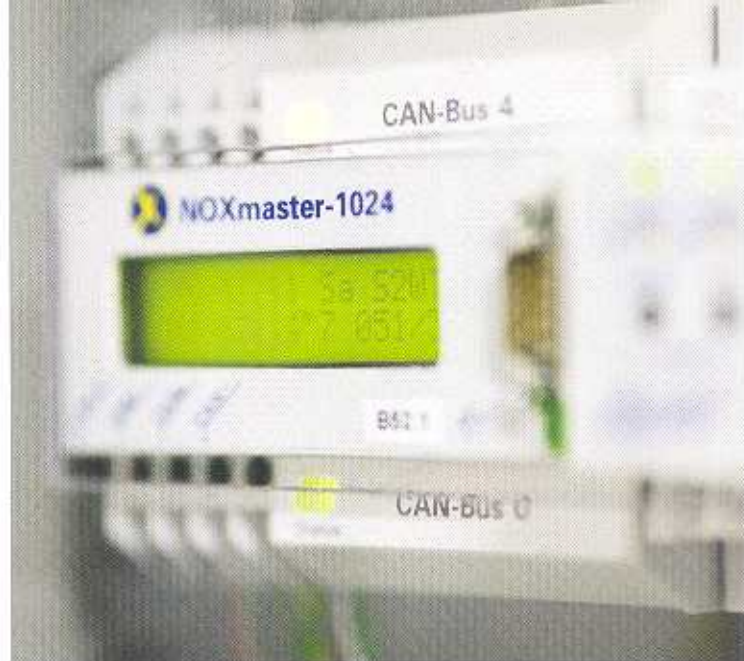
Der „NOXmaster“ ist das zentrale Steuergerät der Hausautomation und passt in eine Schiene des Elektroverteilers.
